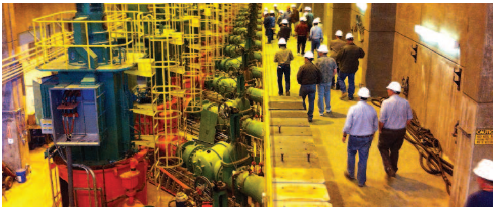
Visitantes recorren el interior de la Planta de Bombeo de Pacheco ubicada unos 24 millas al este de Hollister. El agua es bombeada desde la planta a Hollister a través del conducto de Hollister.
